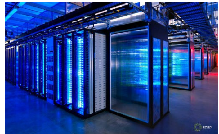
Rechenzentrum von Facebook in Pineville
